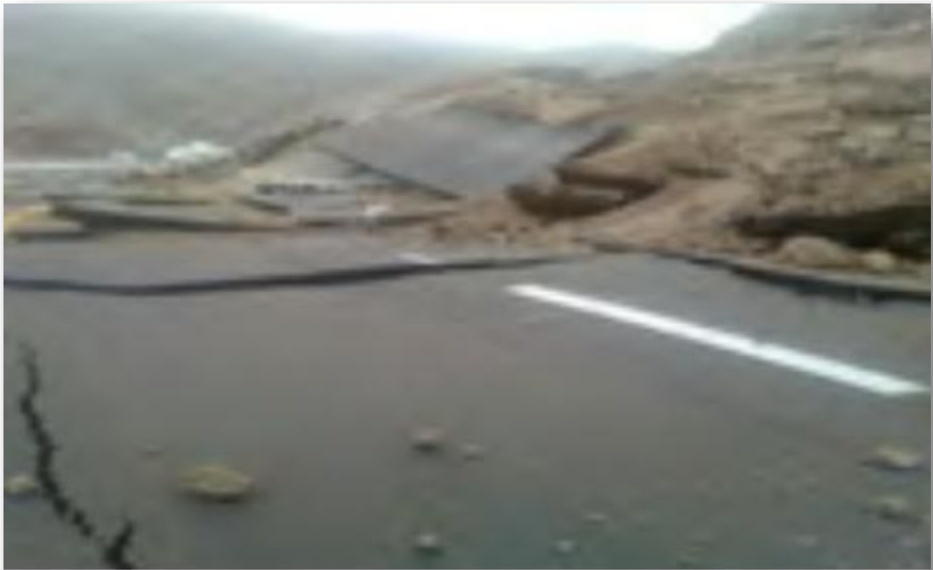
شکل ۹-۴: لغزش در ترانشه یک جاده
