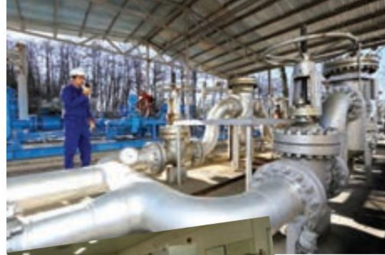
منطقه شمال، ایستگاه فشارشکن لاجیم
