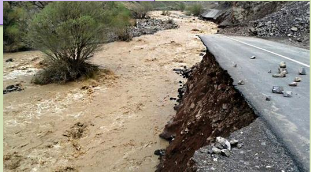
شکل ۱۹- تخریب بخشی از جاده چالوس در اثر طغیان رود
