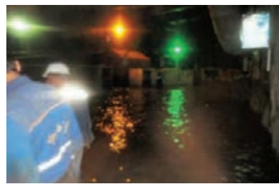
شکل ۱۰-۶ هجوم آب، گل و لای در زمان حفاری تونل ها
