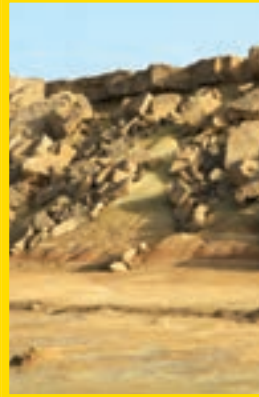
شکل ۱- الف) سنگ در حال تخریب
