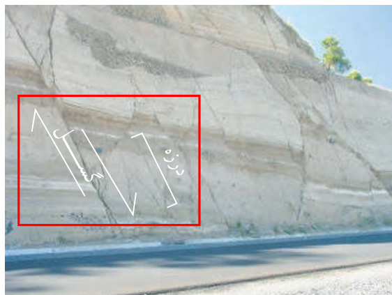
شکل ۱۵- مقایسه درزه و گسل (آذربایجان شرقی)
